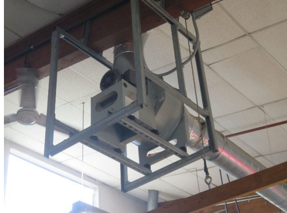
Exhaust Fan Capture Unit
