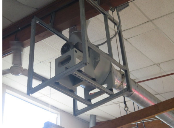
Exhaust Fan Capture Unit
